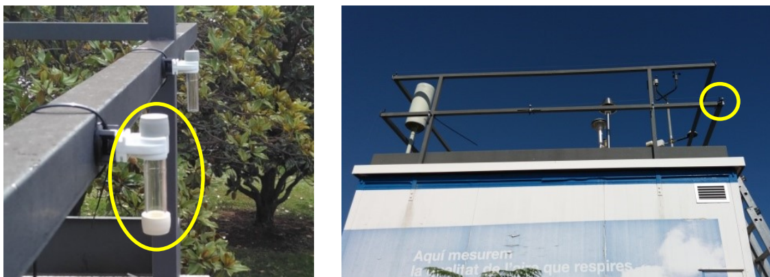
Figura 2: Tub de control (a la primera imatge). A Mataró el tub de control s'ha instal·lat a l'Estació de Referència de la XVPCA (punt 16).
