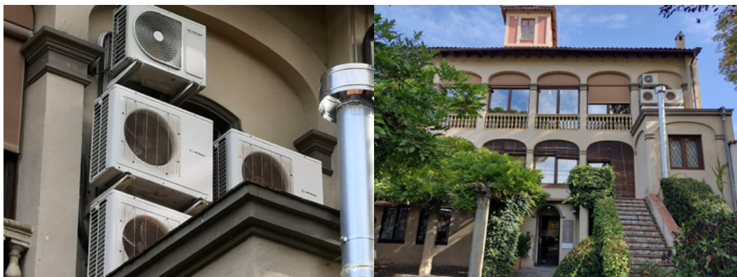
Fig. 15 Unitats exteriors de les bombes de calor aire-aire (Cas núm. 2). Font: SUNO
