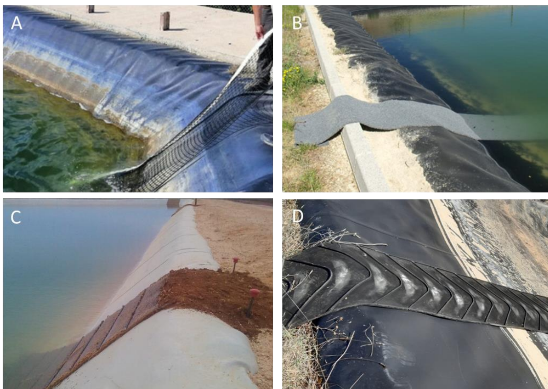
Figura 4. Diferents tipus de rampes de sortida instal·lats en basses d'acumulació d'aigua que compten amb revestiment de geomembrana. Totes aquestes opcions (i en particular A i B) poden tenir riscos pels mitjans aeris, si no es garanteix que estan totalment fixades al substrat, ja que poden ser desplaçades per les turbulències provocades pels mitjans aeris d'extinció (Fonts: FauNatura (A); APAMCV, 2022 (B); GREFA, 2018 (C); Projecte AQUILA a-LIFE (D)).
