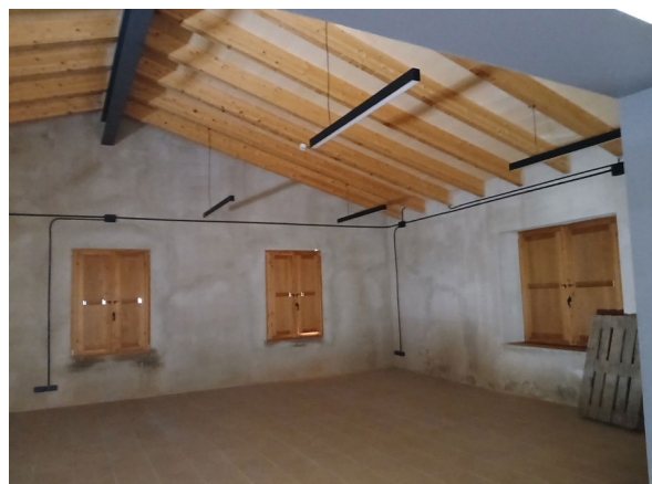
Nou sistema de il·luminació de la primera planta del corral de llevant de Can Bosc. Font: Arxiu XPN
