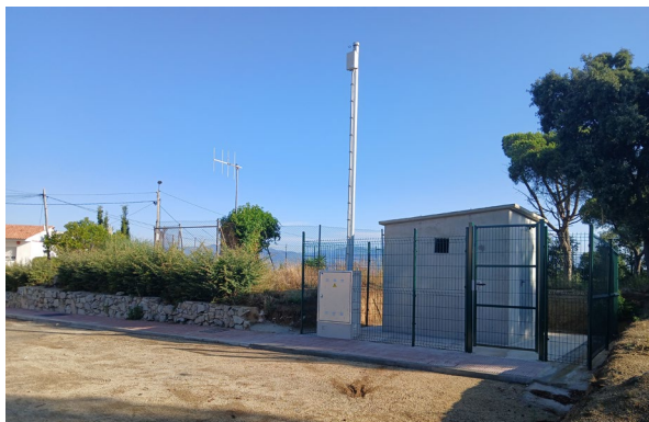
Nova caseta d'instal·lacions de la nova canalització d'aigua de Can Bosc. Font: Arxiu XPN
