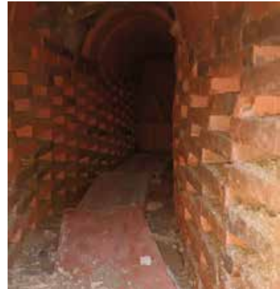
Estat de la mina de Santa Maria abans de la reparació. Font: Arxiu XPN
