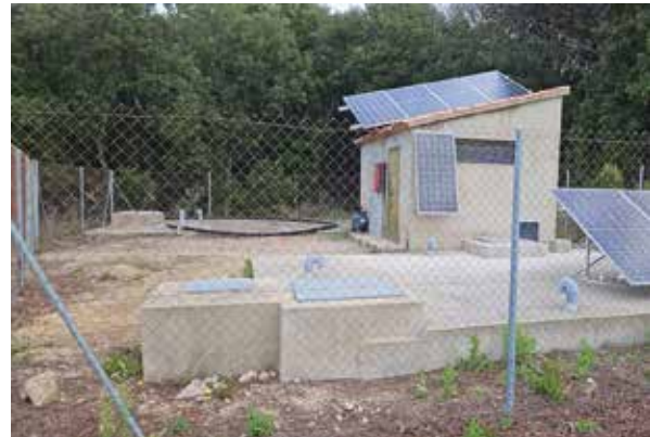
Instal·lació de noves plaques per poder alimentar tot el sistema nou de cloració. Font: Arxiu XPN
