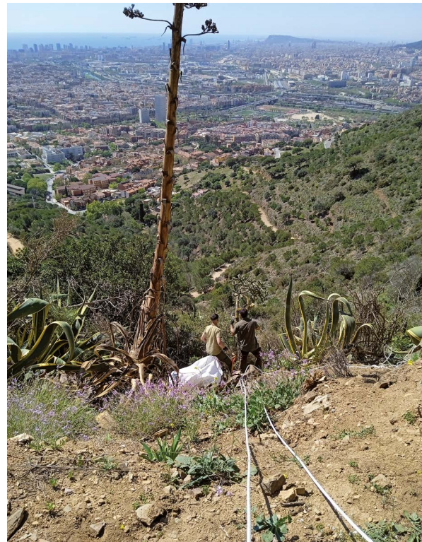
Elements de seguretat instal·lats al torrent de Vall-Ilosera. Font: Arxiu XPN
