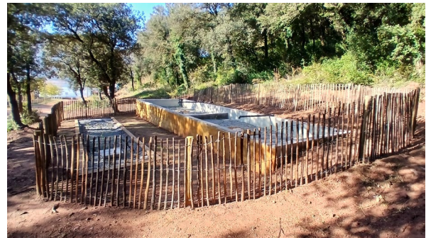
Instal·lació d'un filtre verd per la depuració de les aigües del Centre d'Informació de Vilanova de Sau. Font: Arxiu XPN
