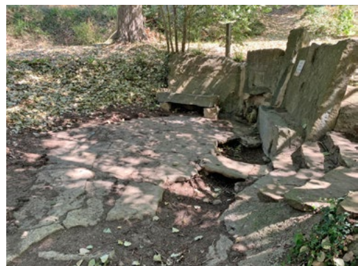
Retirada de la terra i el material vegetal de l'entorn de la font de l'àrea d'esplai de la Font Trobada. Font: Arxiu XPN
