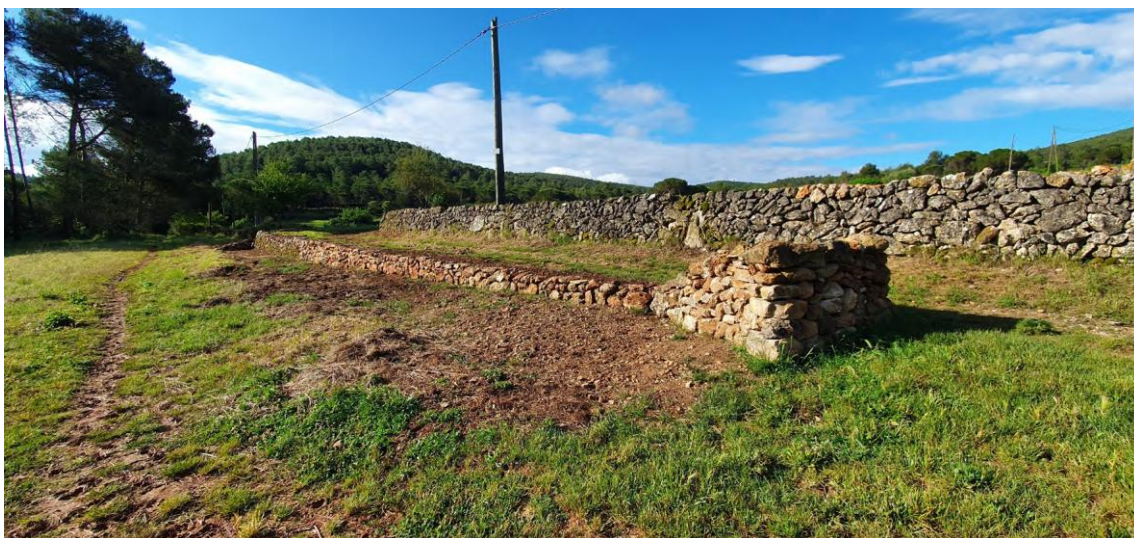
Marge de contenció del camí de Sitges amb un molló de senyalització (VMV, Begues, 2020).
