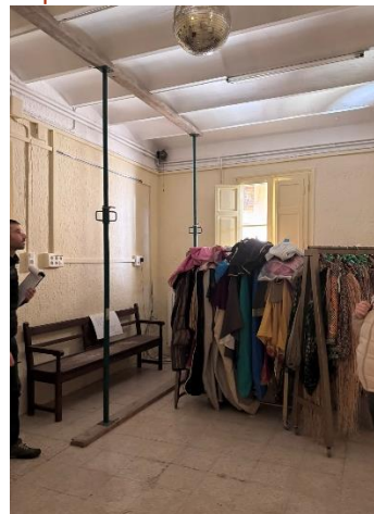
Foto 21. Salas amb problemes arquitectònics
