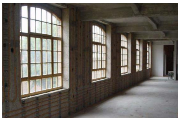
La imatge mostra el sistema d'instal·lació en qüestió (abans de l'aplicació del guix) que consisteix en canonades de coure revestides de plàstic i plenes d'aigua, després de la prova d'estanquitat.
