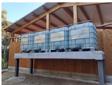
Instal·lació de dipòsits per a la recollida d'aigua de la pluja. Font: Arxiu XPN
