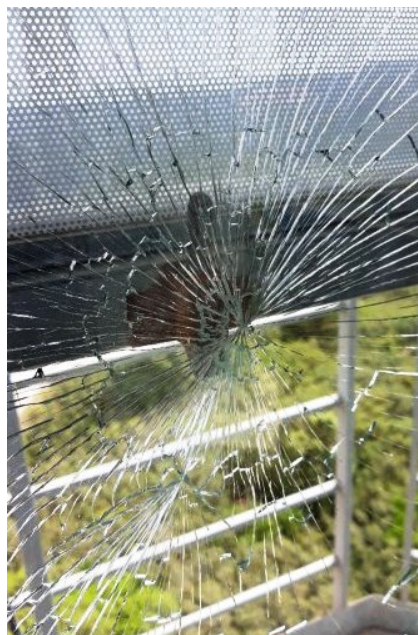
Detall d'un vidre trencat al turó Gros. Foto: Arxiu XPN
