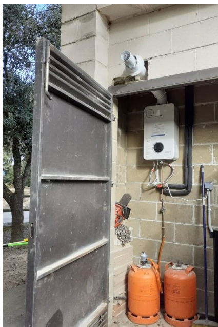
Nova ubicació i nou escalfador d'aigua. Foto: Arxiu XPN
