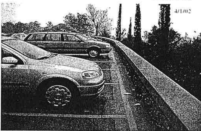
Existència de mur, evita drenatge longitudinal
