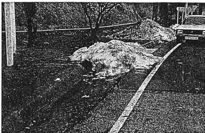
Drenatge transversal, mig obaturat, en la cruïlla de la O.D. 4+400
