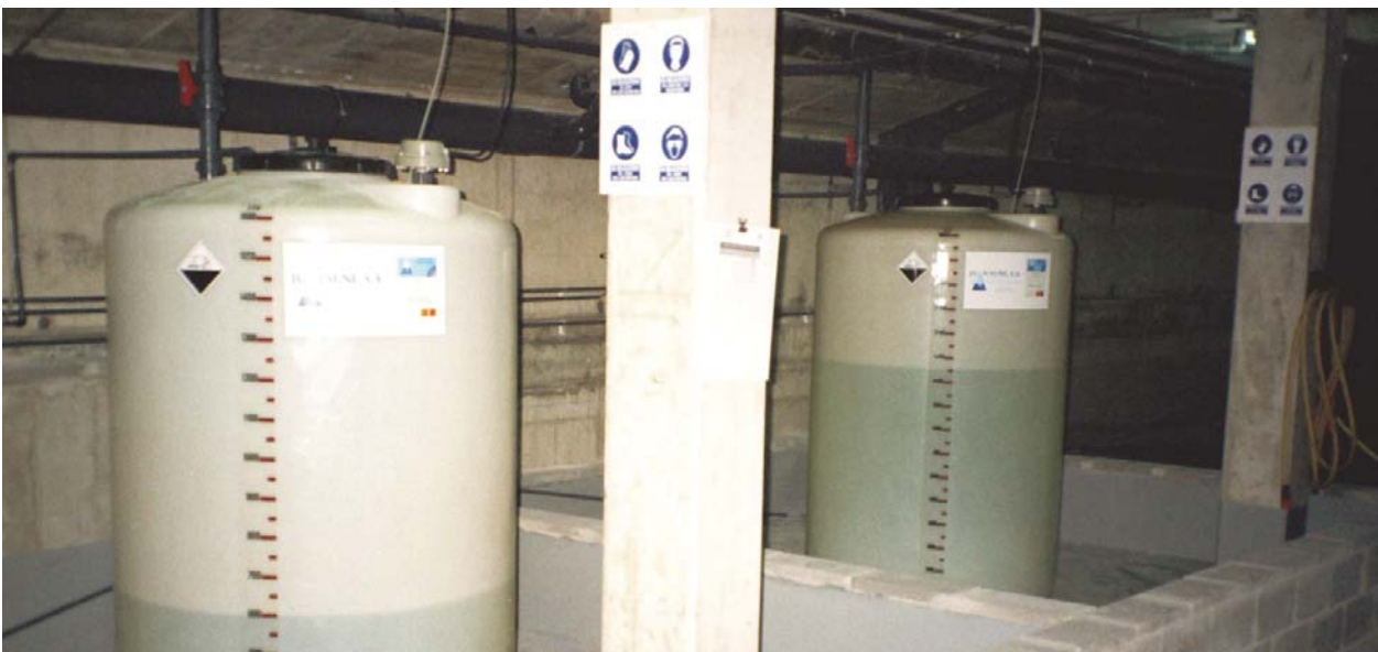
Imatge 3.4. Emmagatzematge de productes químics amb cubetes de retenció d'obra
