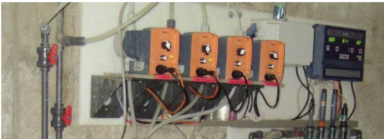
Imatge 2.4. Autòmat de control i bombes de dosificació de productes químics
