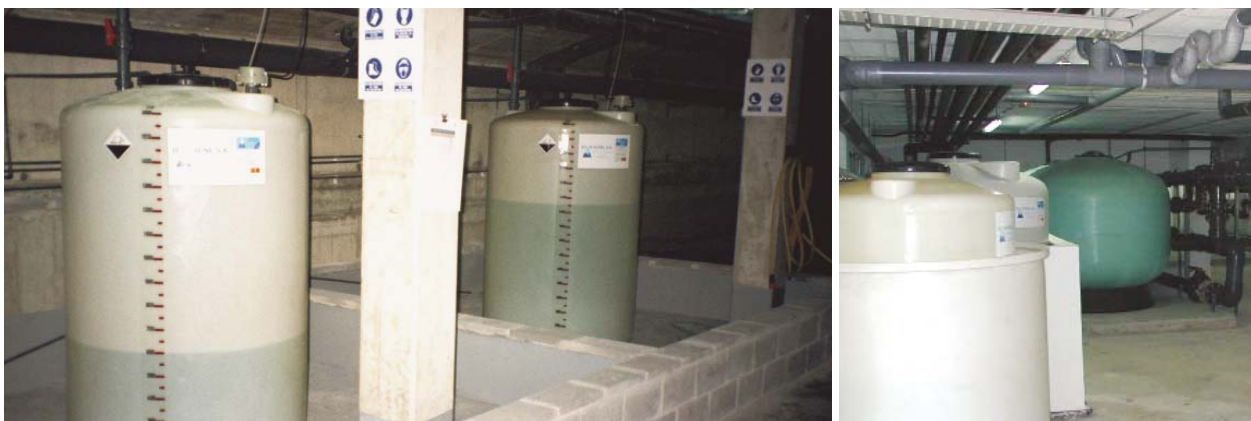
Figura 8. Dipòsits de productes químics amb cubets de retenció d'obra i de plàstic
