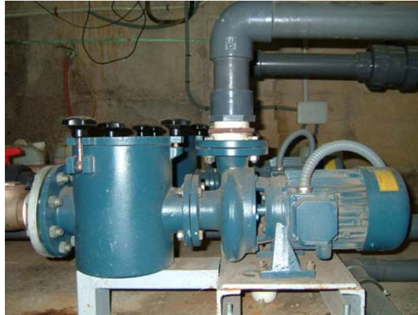
Prefiltre, bomba i motor elèctric de recirculació d'aigua
