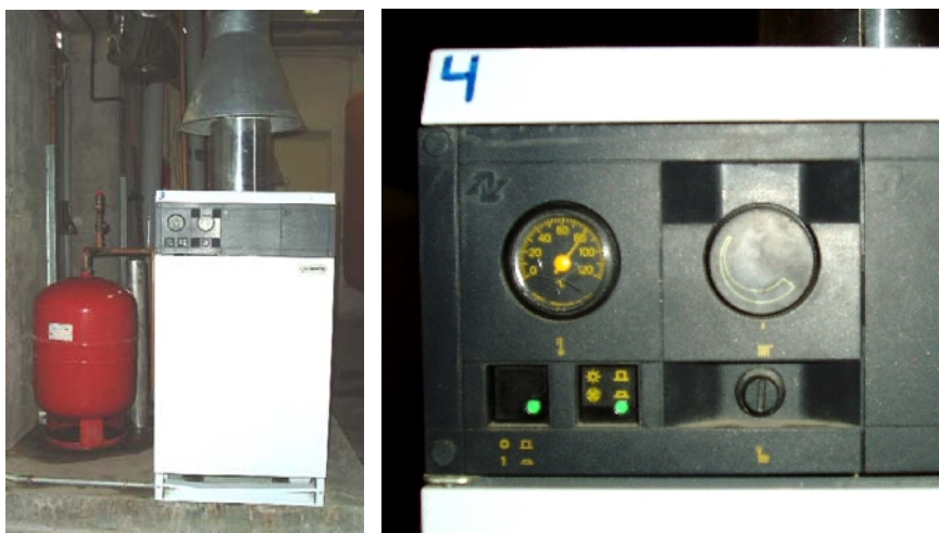
Comprovació funcionament caldera i anotació temperatura
