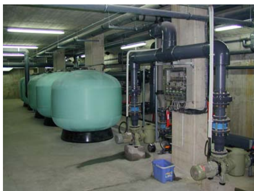
Equips de recirculació i filtració
