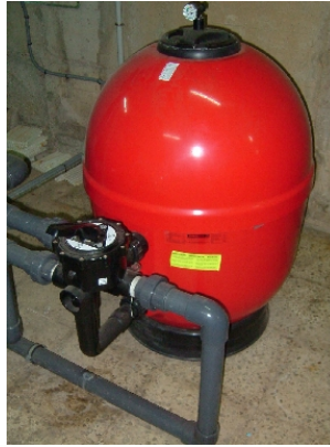
Manòmetre a capçalera d'un filtre
