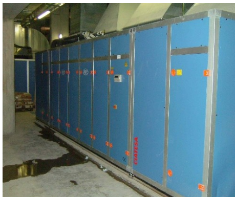
Bomba de calor deshumectadora
