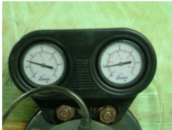
Manòmetres de control de la saturació d'un filtre
