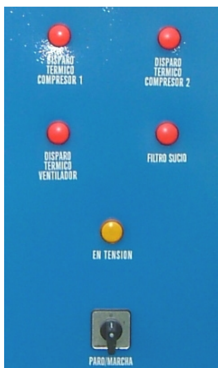
Quadre alarmes deshumectadora
