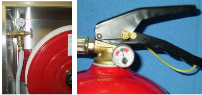
Supervisió visual de que hi ha pressió en els equips de contraincendis
